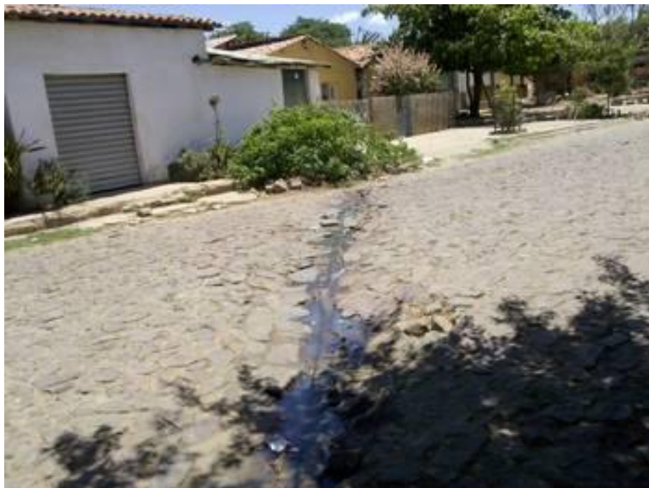
Figura 24 - Esgotamento de águas cinzas em Pedro II
