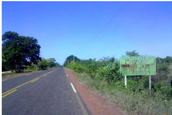
Figura 15 - Trecho sem acostamento e com sinalização precária na PI-117
