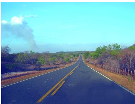
Figura 14 - Trecho de acostamento não asfaltado na PI-225
