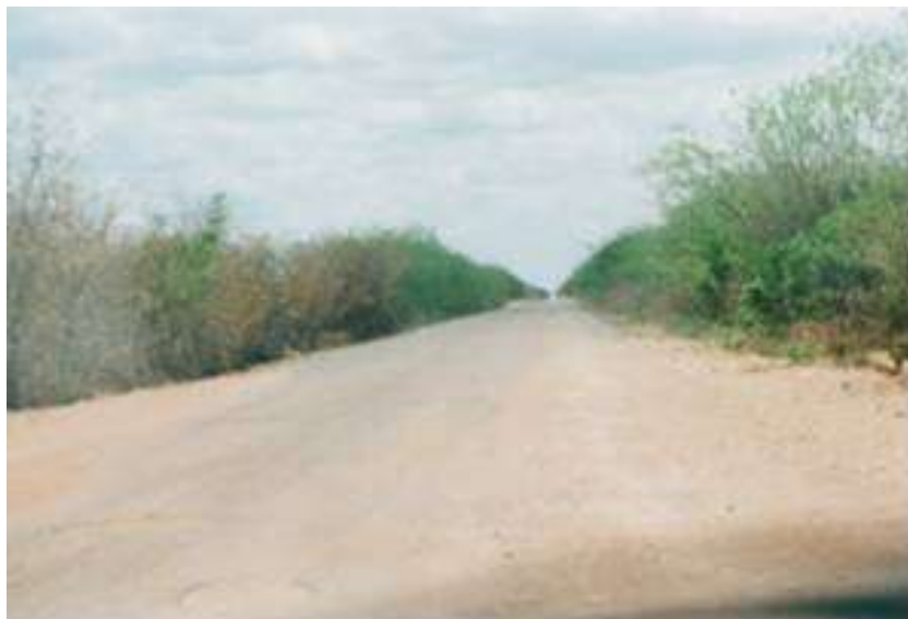
FIGURA 34 - CONDIÇÕES PRECÁRIAS DA RODOVIA PI-140
