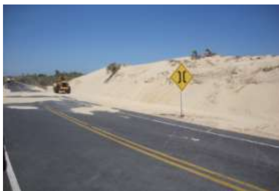
FIGURA 11 - AREIA NA PAVIMENTAÇÃO DA RODOVIA DE ACESSO ÀS PRAIAS DE LUÍS CORREIA – PI 315/PI116
