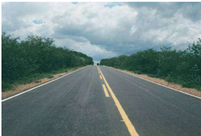
FIGURA 32 - CONDIÇÃO DO ACOSTAMENTO NA BR-020
