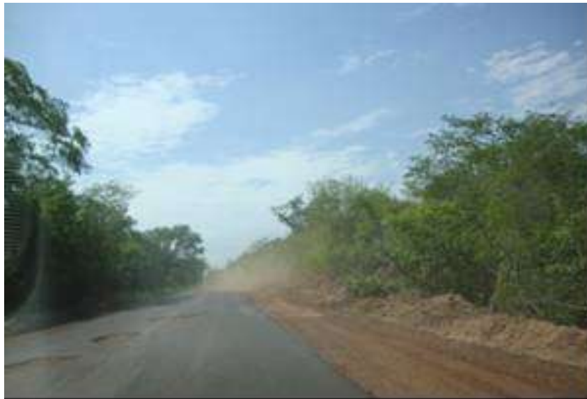
FIGURA 35 - CONDIÇÕES PRECÁRIAS DA RODOVIA PI-140
